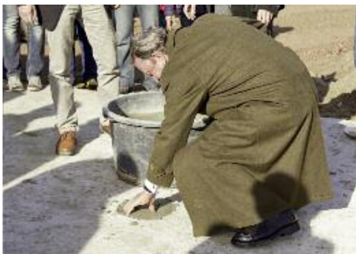
Der Vorsitzende des Schulvereins Carolinum, Herr Jost Reinhold, hinterlässt während der Grundsteinlegung seinen Fingerabdruck.
